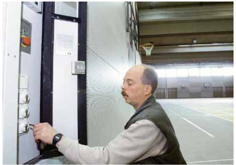
当不同的隔断墙打开或者关闭时，房间的控制将自动调整。原本是在分隔房间单独开关的灯光，现在可以作为大房间整体的灯光来控制。
